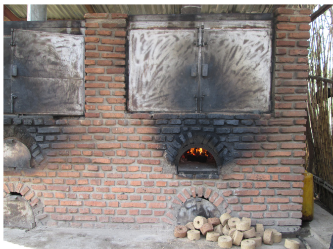
Four à pain alimenté par de la biomasse
